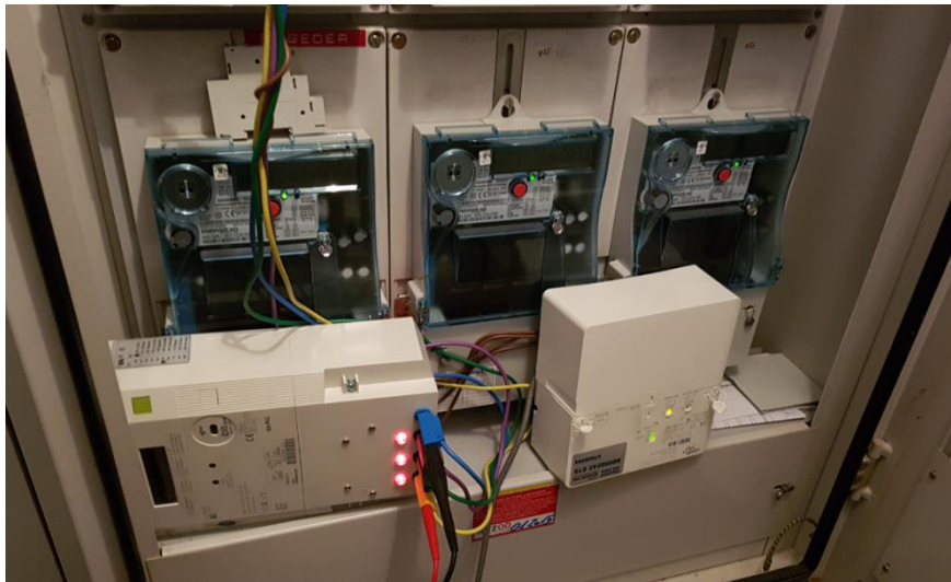
Abbildung 2.3: Zählerraum im Keller der Mehrparteienwohnanlage mit fest installierten Siemens TD3511 Smart Metern (CENELEC A Band) und provisorisch für die Messungen installiertem Landis+Gyr E450 S4 G3 Smart Meter (links unten) und zugehörigem Datenkonzentrator (rechts unten). Foto zur Verfügung gestellt von Ing. Günther Gmeindl (Netz Burgenland).
